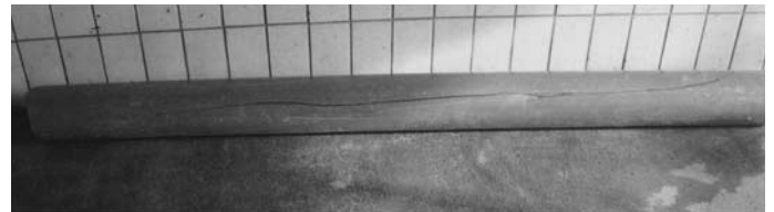
Wasserrohrbruch am 22.07. im Harter Forst
