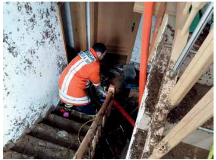
Hitzenau: Ein Haus in Hitzenau wird vom Treibschlamm befreit.
