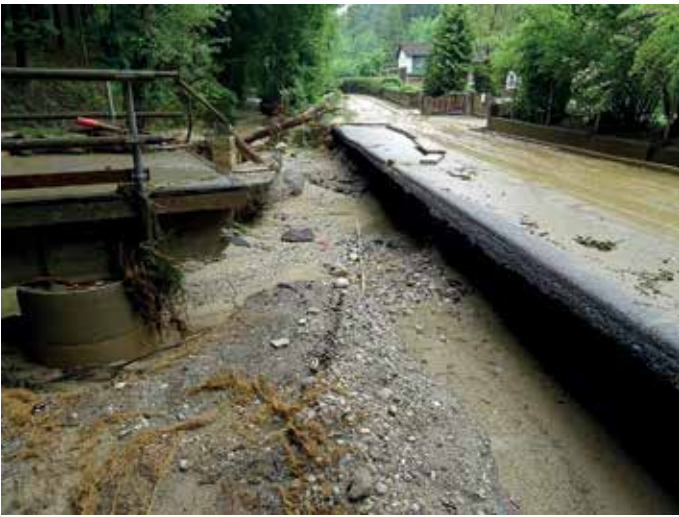
Hitzenau Eckener Straße: Auch in der Eckener Straße hinterließ das Hochwasser schwere Wunden.
